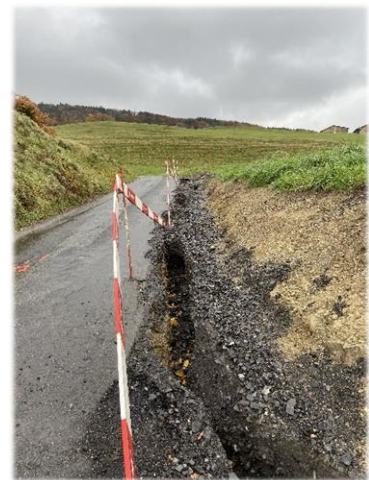
Dégâts sur une route
