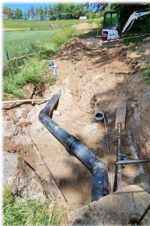
Chantier aux abords du lac de Bret – Reprise des conduites de l'AIEJ
